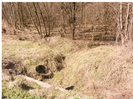
Obr. 5. Viditeľné zvyšky zaniknutého vejárovitého zaústenia vodného jarku do toku Kysuce, odrezané líniou štátnej cesty; Foto: K. Weis (2019)
